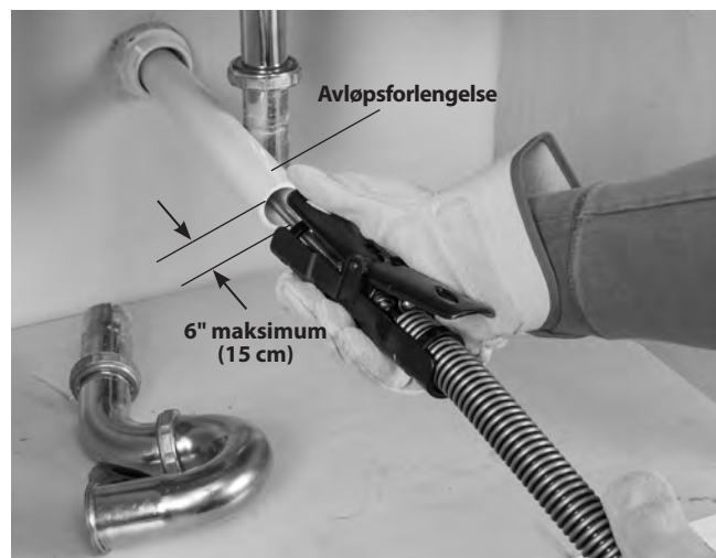
Figur 7 – Eksempel på utvidelse av sluket så det er innenfor 6" (15 cm) for AUTOFEED-enheten.
